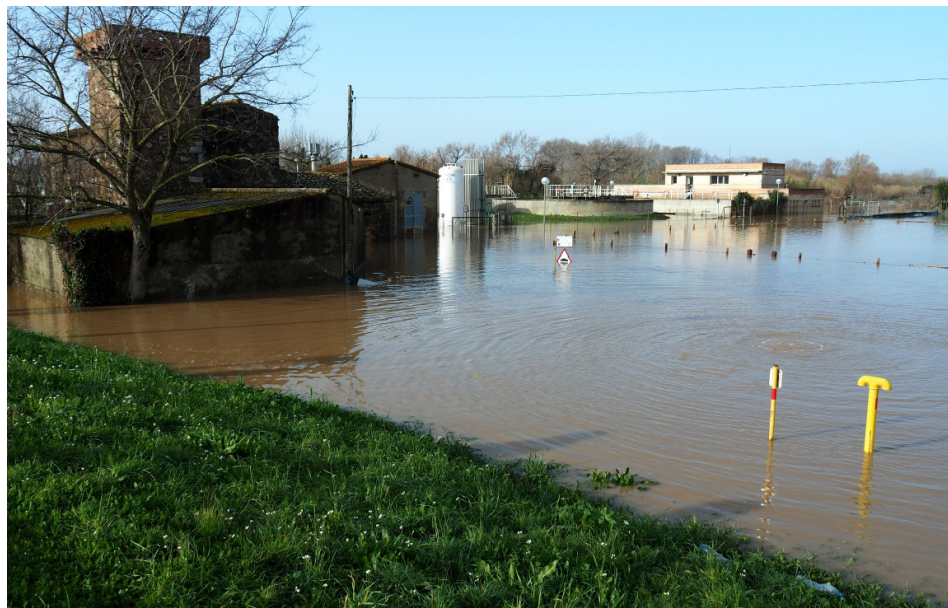
Figura 6. Planta de tractament d'aigua potable de Torroella de Montgrí-l'Estartit inundada
