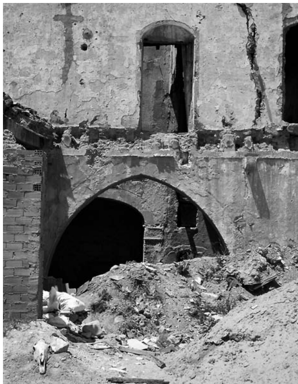
El predomini de l'agricultura a temps parcial i l'expansió del monocultiu cítricol ha comportat l'abandonament de les antigües alqueries. En la foto, estat actual de l'Alqueria del Pi (s. XV)
