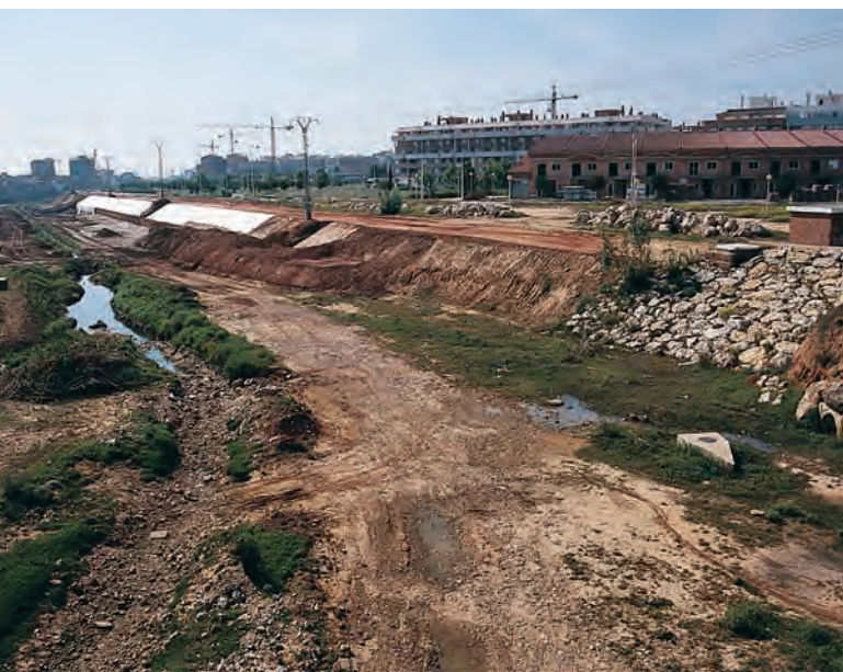
Obres del barranc de Xiva al terme de Catarroja (abril 2003). Vora el barranc, urbanitzacions i edificis de nova construcció.
