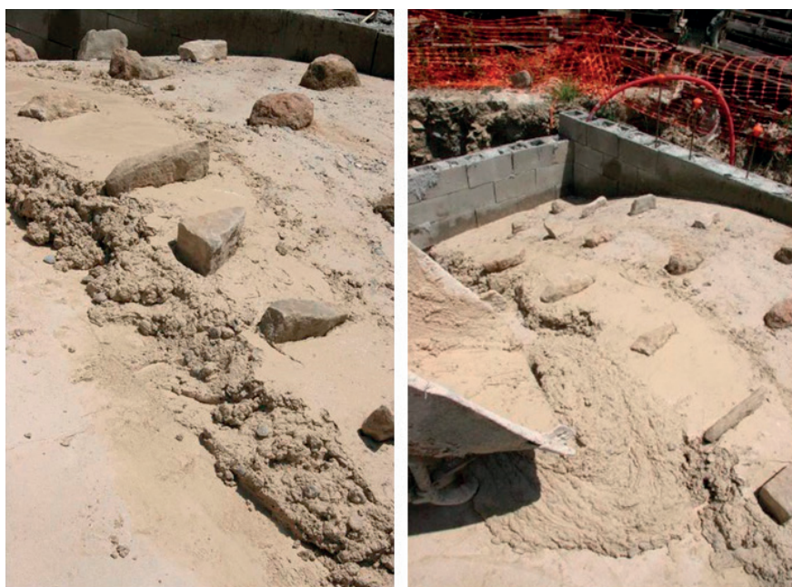
FIGURA 7. Dues fotografies d'Oriol Rosselló que mostren el procés de formigonar per tongades i els connectors de pedra, de la volta.
